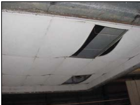
Foto – Verlaagd plafondstelsel na afloop van de brandproef.
