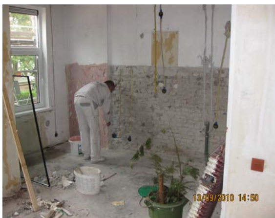
Figuur 3.3: Stukadoor aan het werk in een te renoveren woning (stukadoor behandelt de zui-gende ondergrond – een afgebikte gemetselde bakstenenwand – voor met een grondeermiddel)
