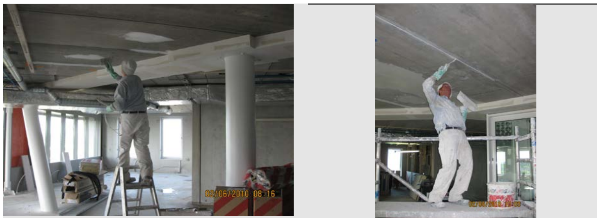
Figuur 4.21: Het plaatselijk repareren van de ondergrond (foto links) en het afwerken van V-naden (foto rechts)
